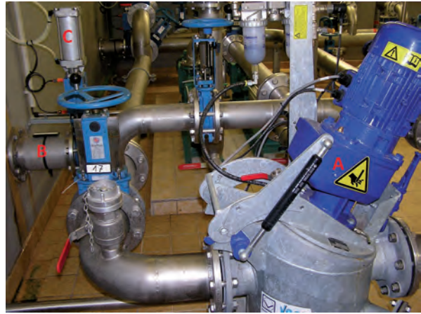
Abb. 9: Maschinelle Einrichtung bei der Faulbehälterbeschickung
